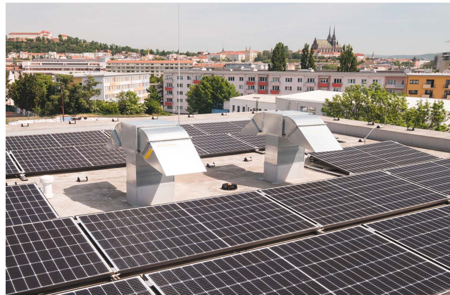
Fotovoltaika na střechách a zeleň okolo – i to je dnešní Brno. (© SAKO Brno)
