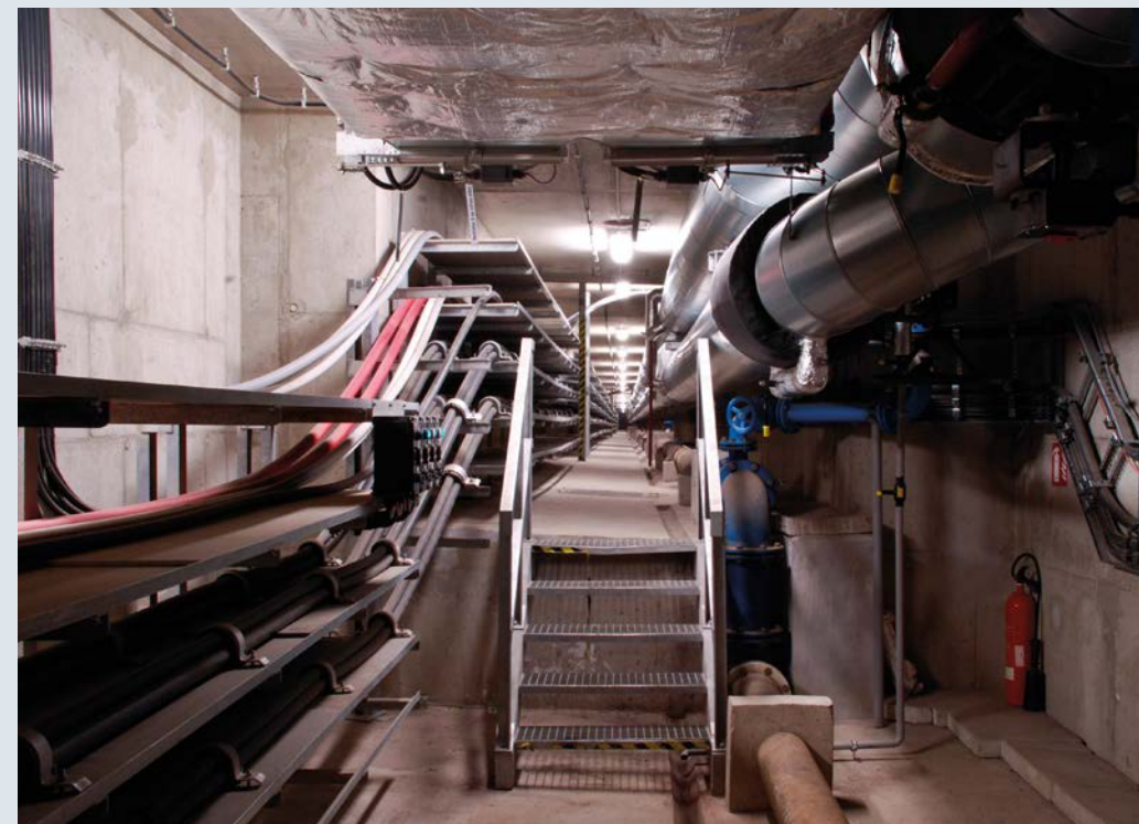
Sekundární kolektor Jižní centrum (© Technické síťe Brno)
